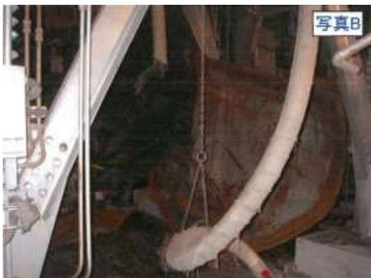
写真 B 1号水砕槽損傷(南側から撮影)
