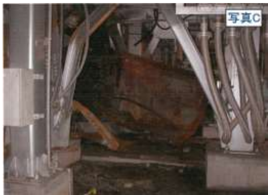
写真 C 1号水砕槽、炉本体架台損傷 (南西側から撮影)
