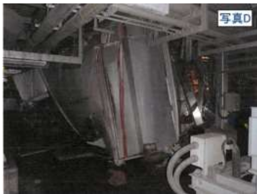
写真 D 1号水砕槽損傷(北西側から撮影)
