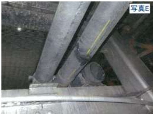
写真 E 2号灰熔融炉付近 水砕水配管の損傷 (西側から撮影)
