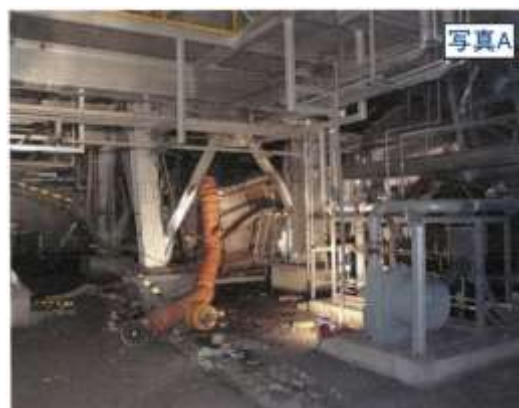
写真 A 1号水砕槽、炉本体架台損傷 (南東側から撮影)
